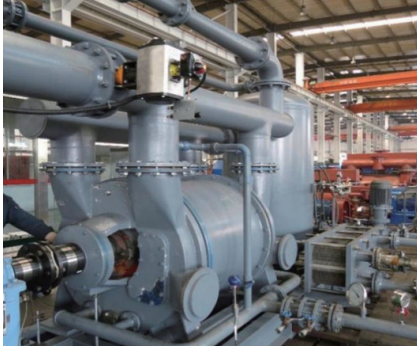
图3 液环泵真机测试系统
